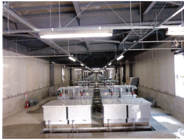
浮上槽棟及び浮上槽
